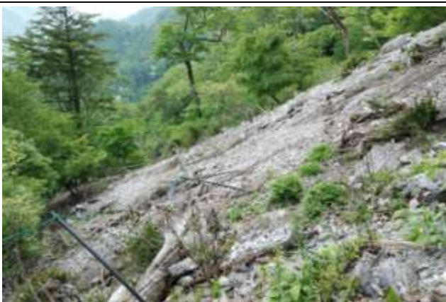
倒木落下による破断 09.06.07
